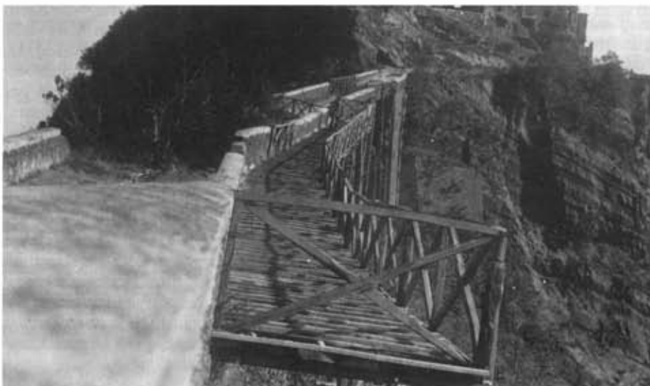
Vista della passerella e del ponte da tramontana; notisi la scomparsa ormai avvenuta di molte parti dei massi tufacci e dei manufatti.
