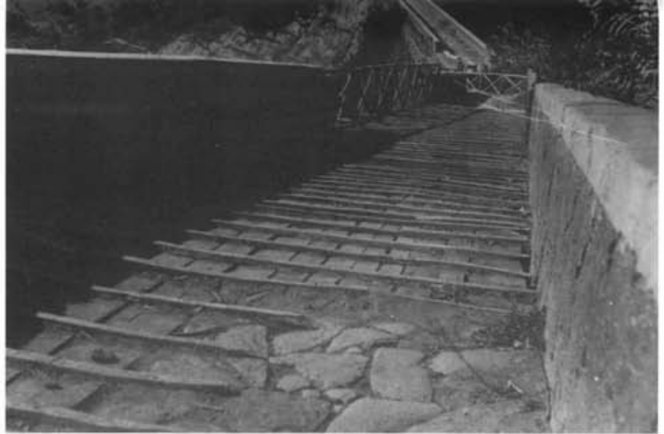
Vista del ponte e della passerella dalla parte di Civita: in primo piano notisi il selciato come consigliato nella relazione dell'architetto Bracci, indi il tavolame per non appesantire troppo le strutture.
